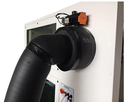
Foto Ilustrativa sistema refrigeração
