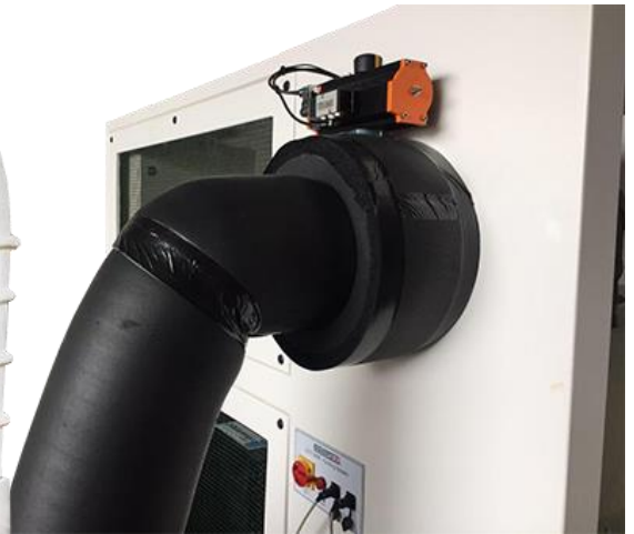
Foto ilustrativa sistema refrigeração
